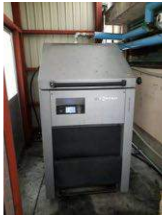
図 4-11 うなジオに導入されている薪ボイラー
