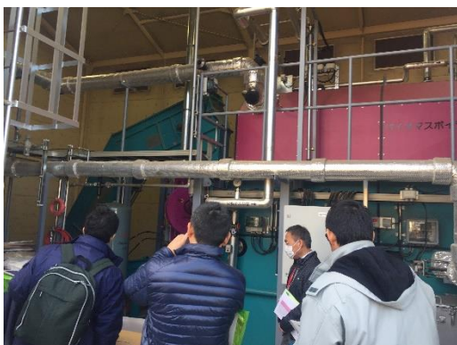
写真 12 常陸大宮市視察（チップボイラー）
