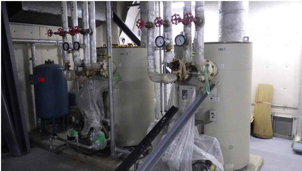
写真 3-17 温水ボイラー外観
