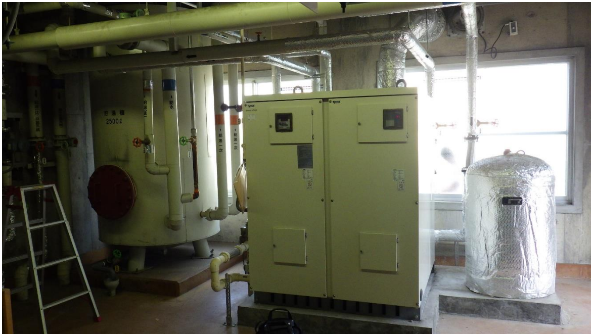
写真 3-20 ボイラーの外観
