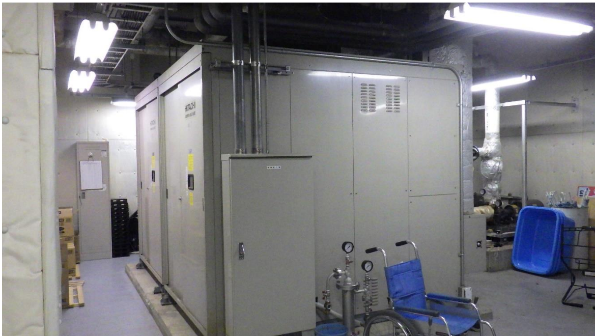
写真 3-18 吸収式冷温水機外観
