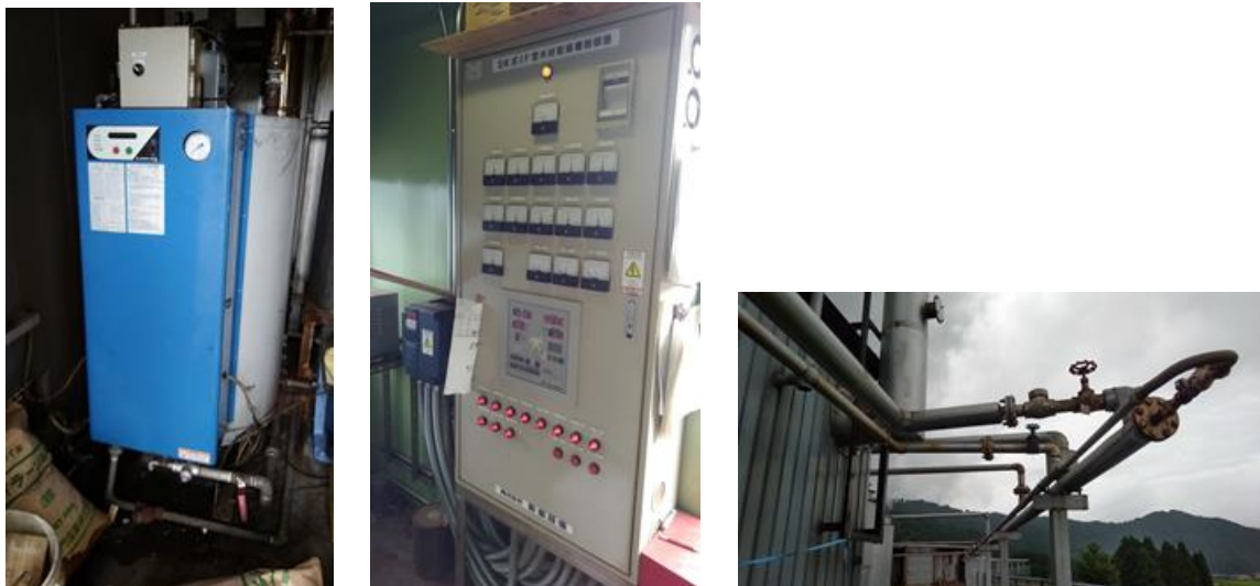
写真 2-11 重油ボイラー周辺（ボイラー本体、制御盤、蒸気・ドレン配管）
