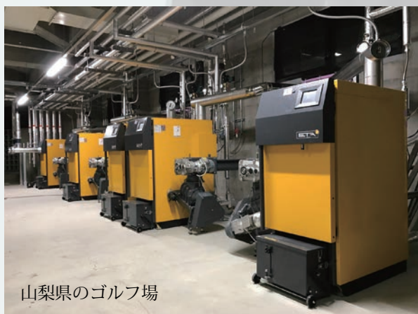
花屋では、コンテナ格納式のボイラー が導入されています。
