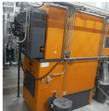
氷太くんの木質ボイラー
