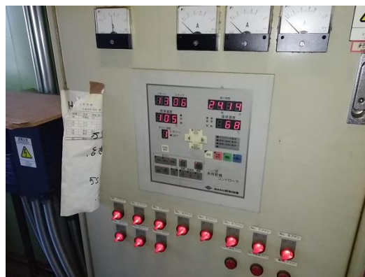
写真 3-6 高温乾燥機制御盤
