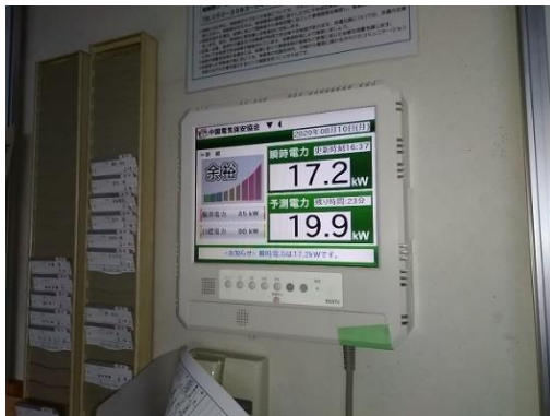
写真 3-14 電力監視モニター
