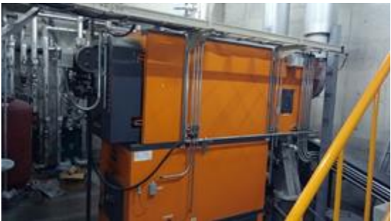
写真 3-11 平成 27 年度導入のチップボイラー
