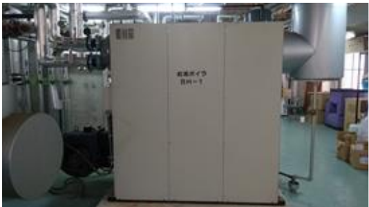
写真 3-12 既存の灯油ボイラー
