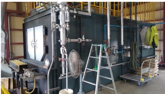
写真 3-8 木屑焚きボイラー
