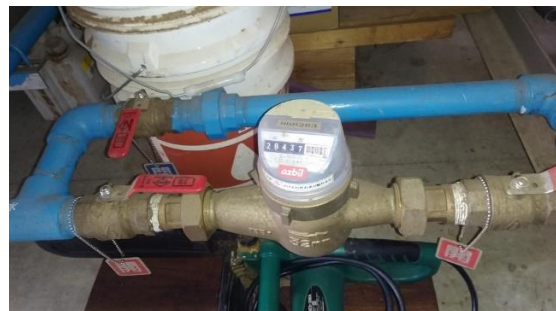
写真 3-9 同ボイラー給水量計
