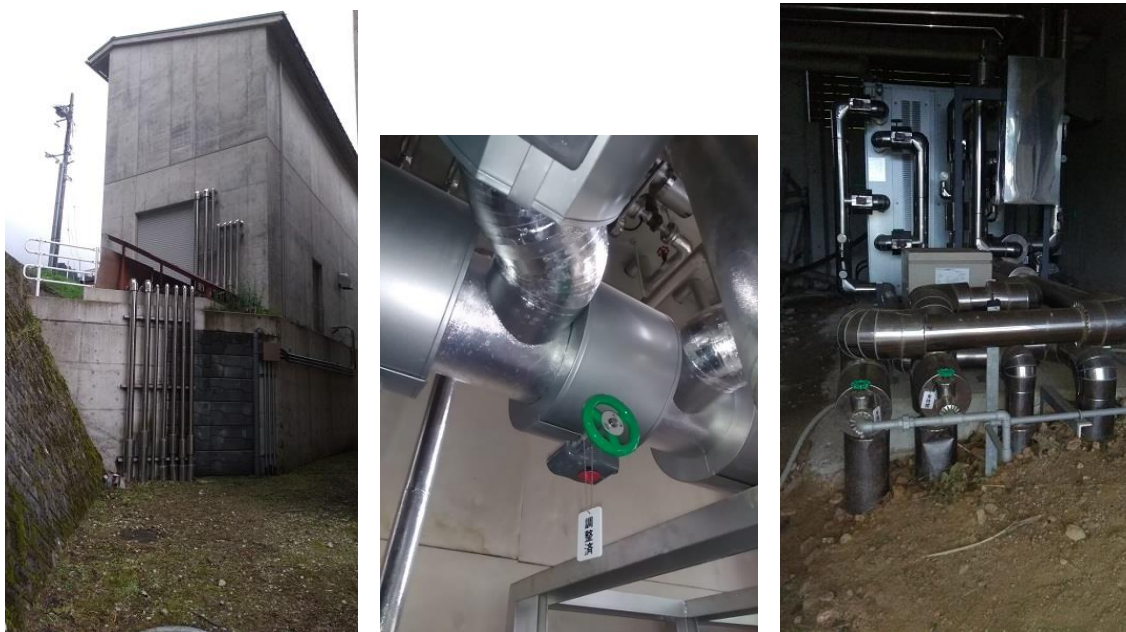
写真 3-13 チップボイラー（左：配管、中央：空調用手动バルブ、右：温水焚き冷温水機）
