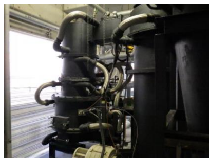
写真 3-3 チップボイラー
