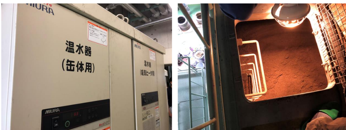
写真 3-2 温水ボイラー・し尿処理槽
