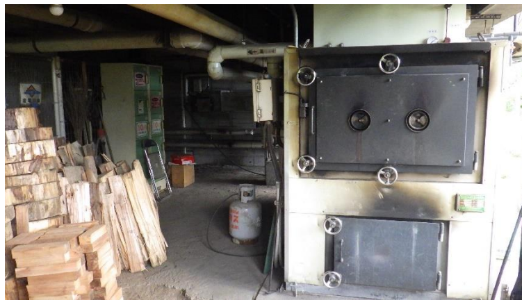
写真 6-11 更新予定の薪ボイラー
