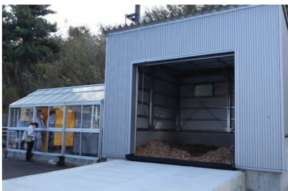
▼チップボイラー（株式会社山本組）
