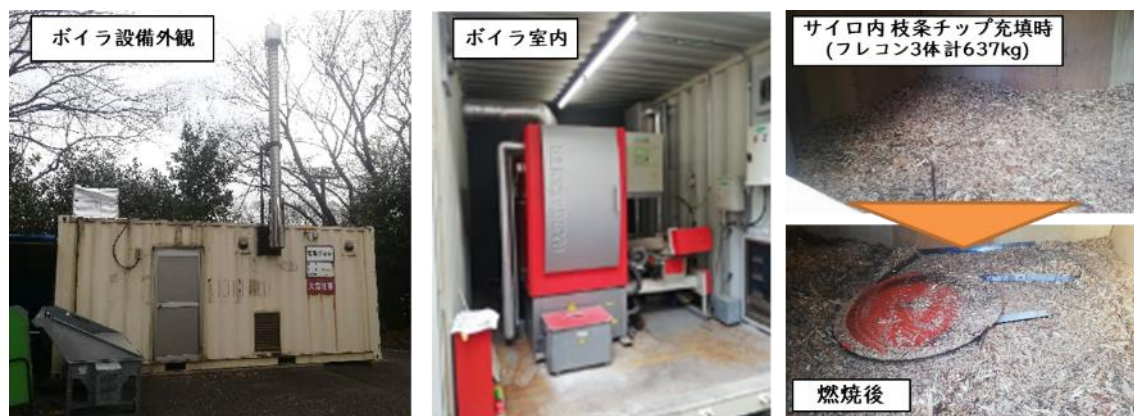
図 3-7 燃焼試験実施設備の外観および実証中のチップサイロ内の様子
