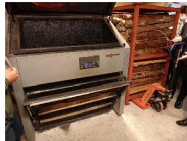
図 3-17 健康パークあざい（薪ボイラー）
