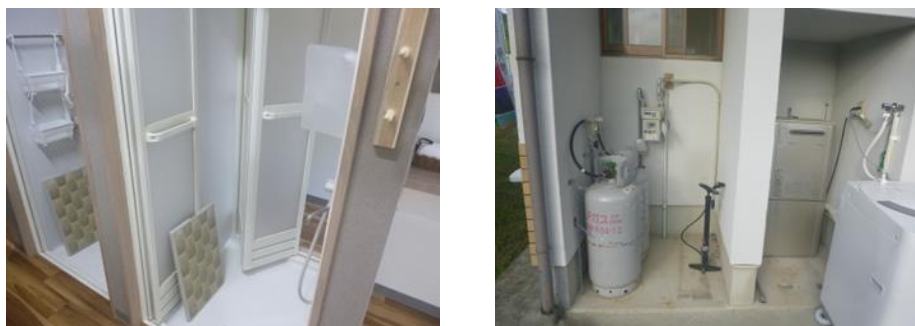
図 3-19 シャワー室 LP ガスボンベ
