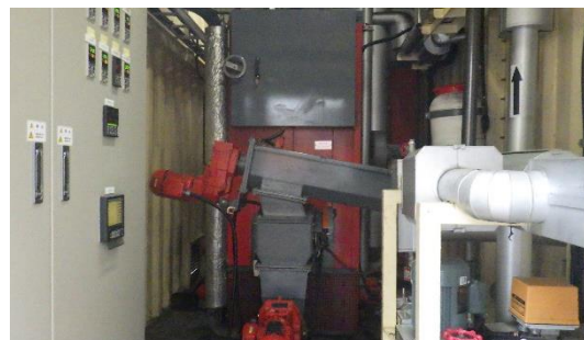
写真 3-3 チップボイラー
