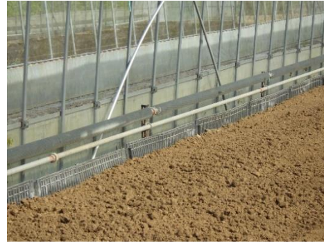
写真 3-8 ハウス内の熱配管
