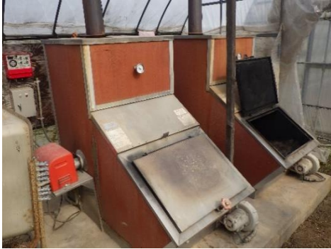
写真 3-7 薪ボイラー N-350NSB
