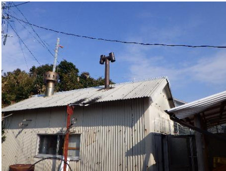
写真 3-24 ボイラー室の外観
