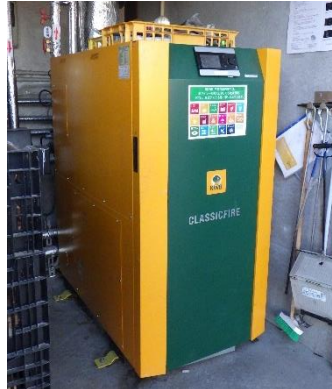
写真 3-8 薪ボイラー (KWB社, 28kW)
