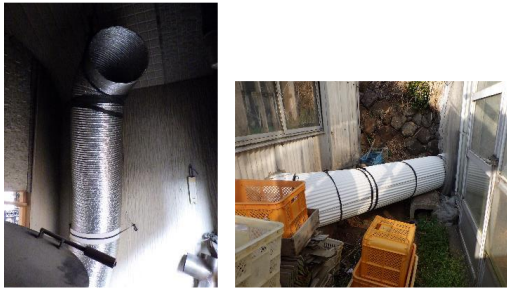
写真 3-30 排熱ダクト（ボイラー室/外）
