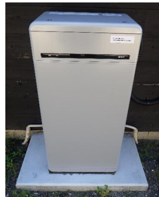
※タイニーハウスの裏手に設置 写真 3-23 太陽光発電用の蓄電池
