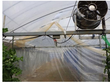
写真 3-40 ハウス（下）の送風機
