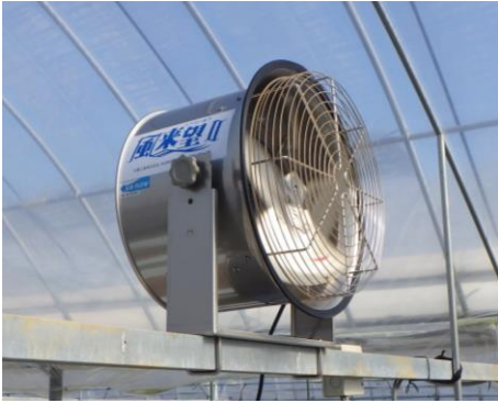
写真 3-39 ハウス（下）の送風機
