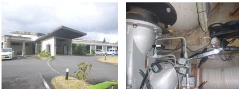
図 3-61 本施設正面入り口、灯油ボイラー燃料計測の様子
