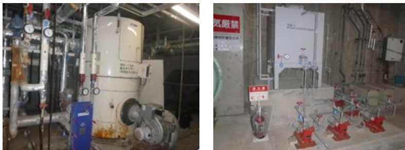
図 3-60 灯油ボイラー、灯油サービスタンク
