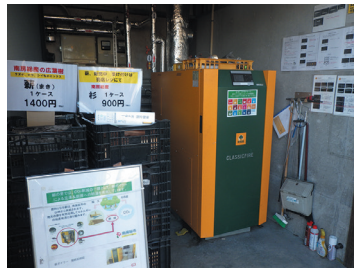
薪ボイラー（道の駅：南房総市）
