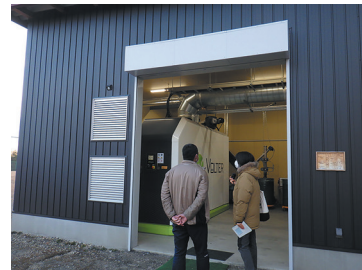
熱電供給設備(渋谷市)
