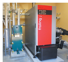
木質バイオマスボイラー
