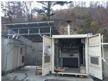
薪ボイラー（温浴施設：筑北村）
