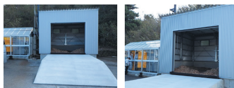
地上式サイロ (スロープ式) (山形県鶴岡市)
