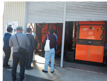
チップボイラー (地域熱供給システム:西粟倉村)
