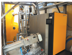
設置したボイラー
