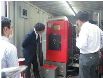
チップボイラー(品川区)
