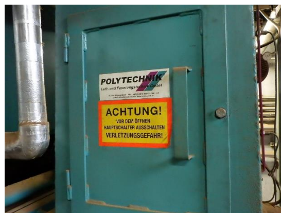
写真 3-10 チップボイラー
