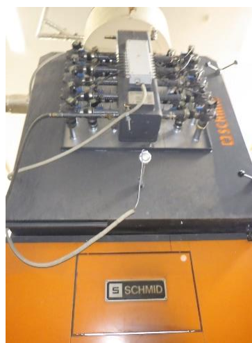
写真 3-8 バーク専焼ボイラー
