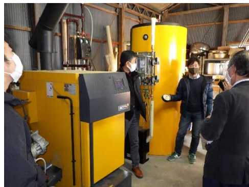
写真 3-14 チップボイラー
