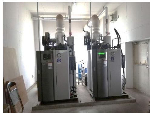
A 重油蒸気ボイラー
