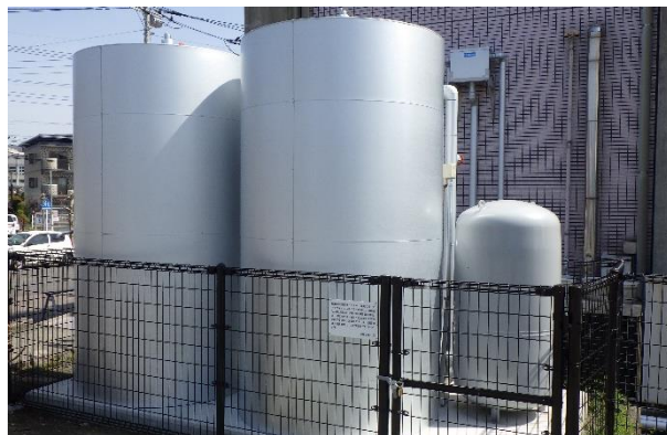
公園側に設置された貯湯槽等
