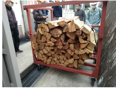
薪ボイラー手前まで搬送した状態
