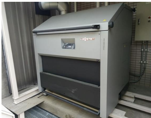
VISSMANN 社 100 kW×1 台を設置 （薪長 100cm タイプ）
