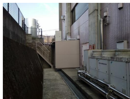
薪ボイラーへの通路 （建屋内に薪ボイラーがある）
