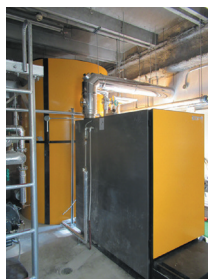
チップボイラー
