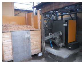
チップボイラー利用
