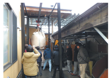
銀河の里 チップボイラーとサイロ
