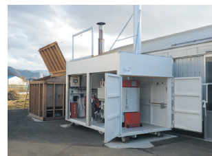
チップボイラー・チップサイロ
